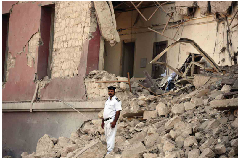
أضرار جسيمة تعرض لها مبنى القنصلية الإيطالية سابقا
