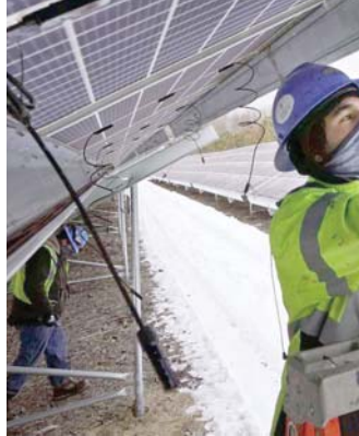
عملية صيانة بسيطة قبل تشغيل المحطة
